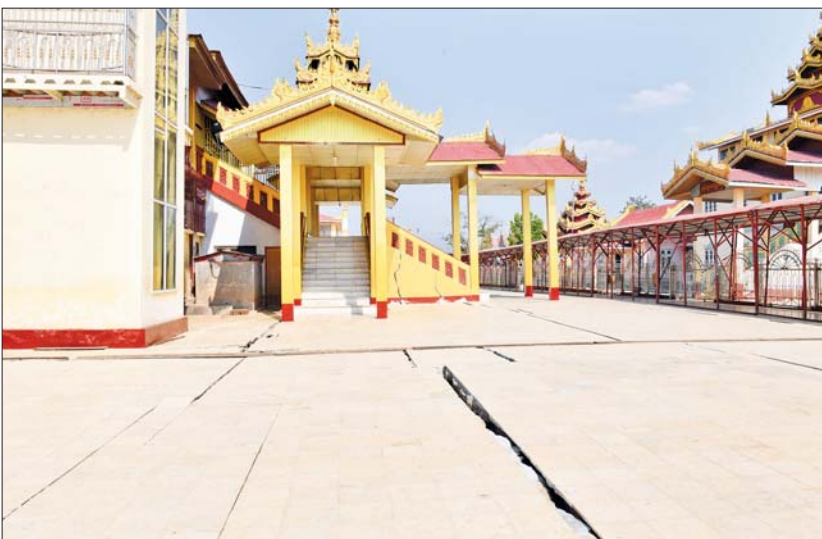
ရတနာစံကျောင်းတော်ကြီးရှိ အင်းလေးဖောင်တော်ဦး ဘုရားရင်ပြင်တော်ရှိ နေပူခံကျောက်ပြားများ၊ မုခ်ဦးများ၊ လှေကားများ ငလျင်ဒဏ်ကြောင့် ကွဲအက်ပျက်စီးနေမှုကို တွေ့ရစဉ်။
