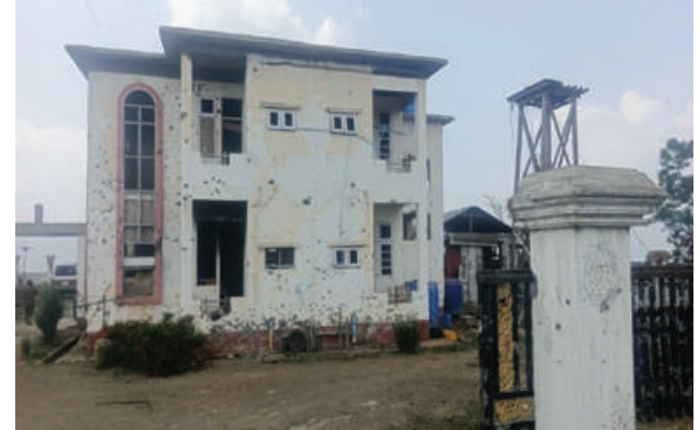
ဌာနဆိုင်ရာ အဆောက်အအုံများ ပျက်စီးမှုမှတ်တမ်းဓာတ်ပုံ။
