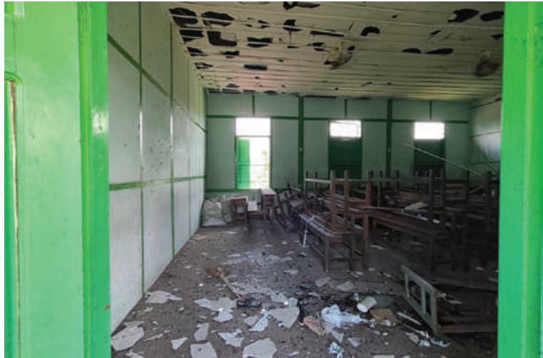
Drone ကျရောက်ပေါက်ကွဲမှုကြောင့် အခြေခံပညာအထက်တန်းကျောင်း(ခွဲ) (အောင်ဇေယျ)ရှိ စာသင်ဆောင်များ ပျက်စီးခဲ့မှုမှတ်တမ်းဓာတ်ပုံ။
