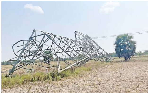
၂၀၂၀ ကေပွီ ရွှေကျင်-သာယာကုန်း ဓာတ်အားလိုင်းဖျက်ဆီးခံရမှုကြောင့် ပြိုလဲပျက်စီးလျက်ရှိသည့် တာဝါတိုင်များကိုတွေ့ရစဉ်။
